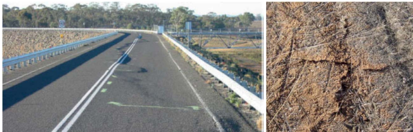
Poruchy na koruně hráze a těsnění v důsledku extrémního sucha (VD Eppalock a Merrimu)
