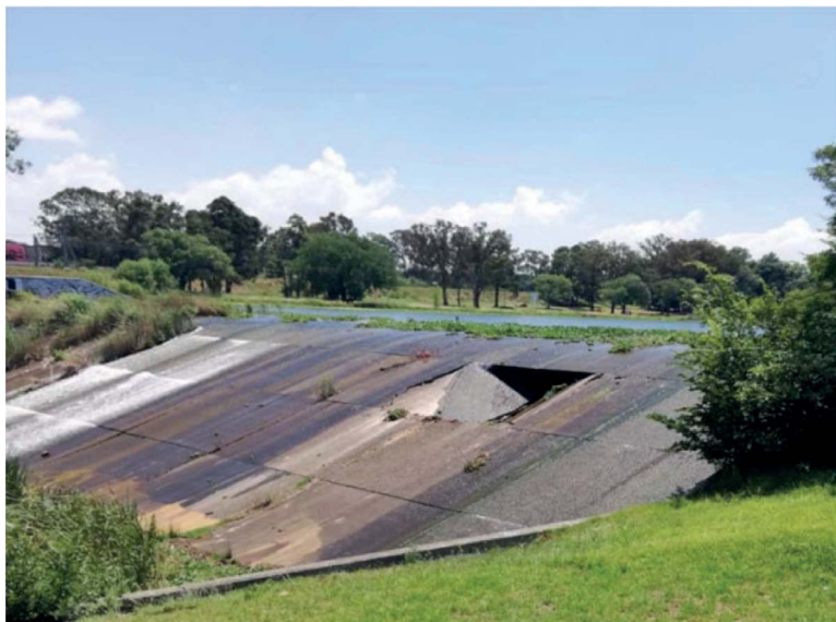
Poškození přelivu na přehradě Middle Lake
