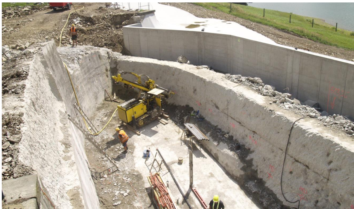
Obr. 1 Staveniště bezpečnostního přelivu, směrem do nádrže provizorní ŽB zed' pro zajištění ochrany stavby před povodněmi
