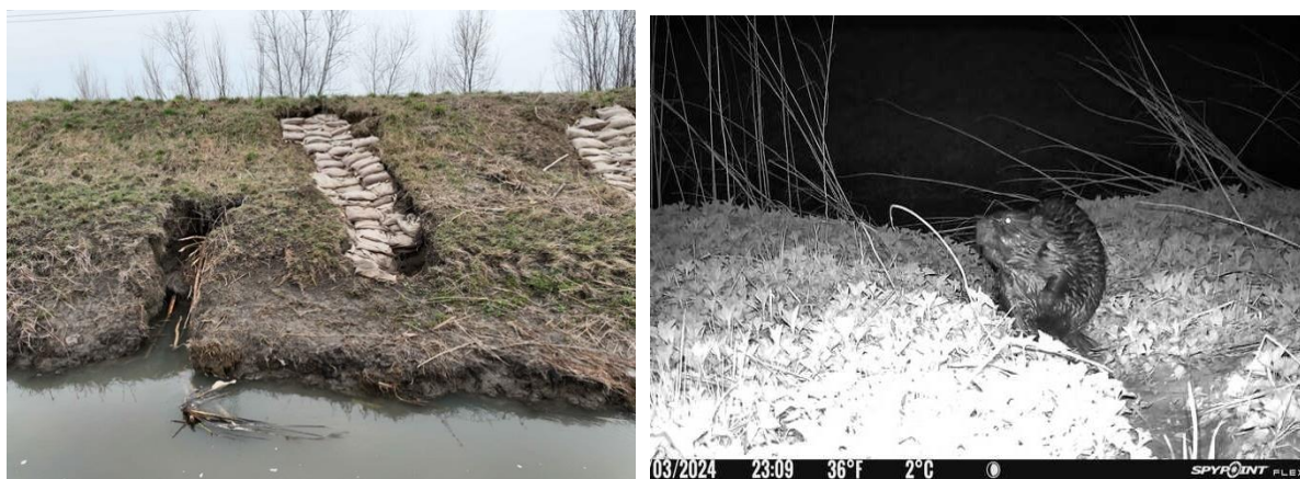
Obr. 3 Poškodenie návodného svahu ochrannej hrádze Trnávky v rkm 15,000 – 16,000 a záber z fotopasce s potvrdenou aktivitou bobra (Foto: S. Farkaš)
