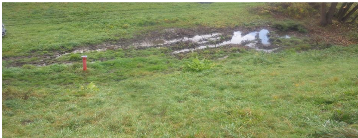
Obr. 2 Prejavy priesaku v km 10,130 na ľavostrannej hrádzi PK Lipovec
