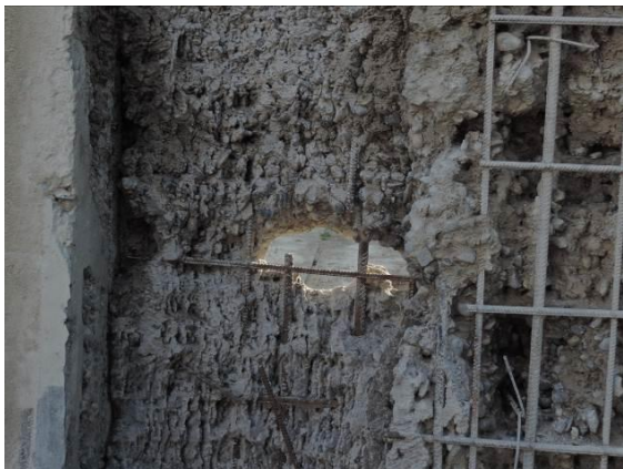
Obr. 3 Pohled na průstřel subtilnější konstrukce v místě oslabení
