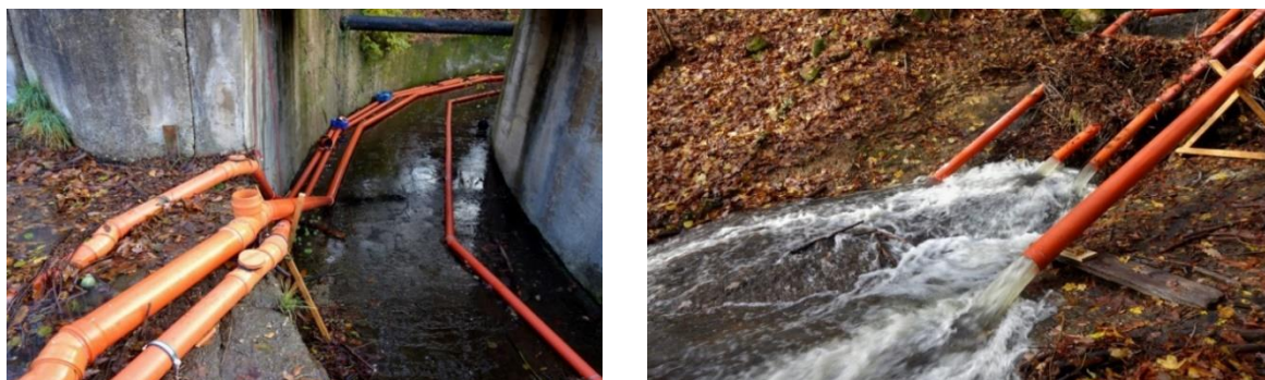
Obr. 2 Pohľad na inštalované násosky v počte 4 ks [4]
