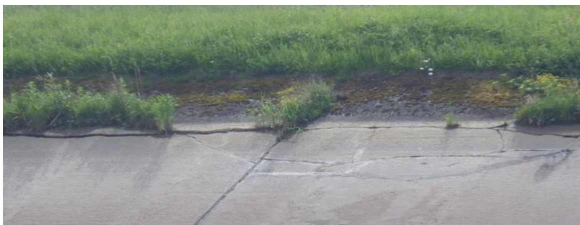
Obr. 1 Ukážka poškodenia betónového tesnenia na PK Sučany (pri zníženej hladine v PK)
