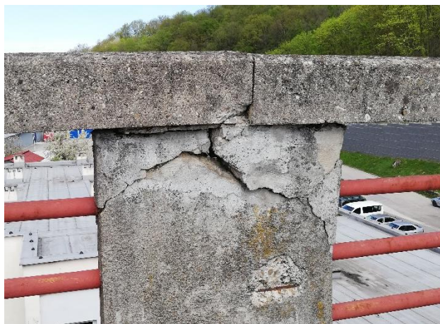
Obr. 4 Poškodenie bet. zábradlia
